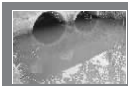
油库下水道直通沟渠
