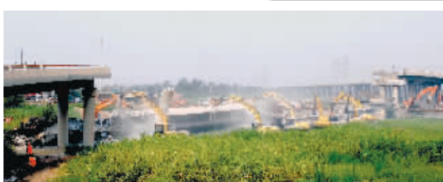
7月15日拍摄的津晋高速公路匝道桥坍塌事故现场。新华社发
