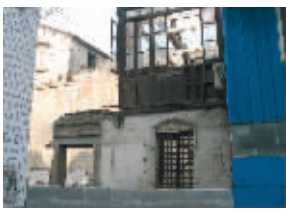
古建的窗户已被破坏
