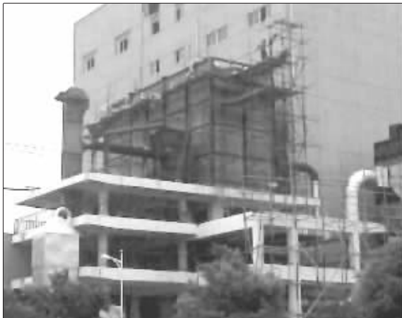
恒诚硅业有限公司未报批就动工的燃煤热风炉装置 陈超 摄
