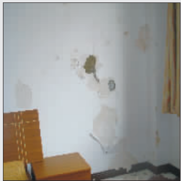
墙面渗水严重,墙皮开始剥落
