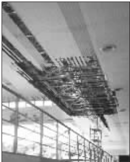
星海游泳馆天花板塌落 王玲玲 摄
