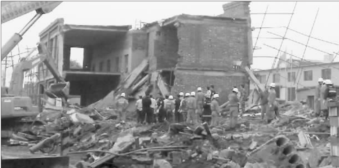
8月4日,消防队员在厂房坍塌现场实施救援 新华社记者 朱峰 摄
