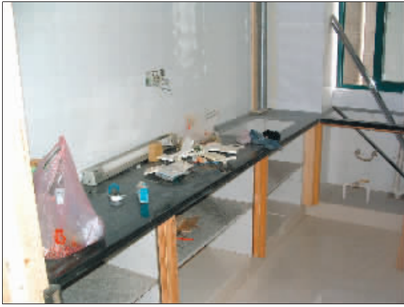
王先生的新房已装修得差不多了,但没有通上天然气
