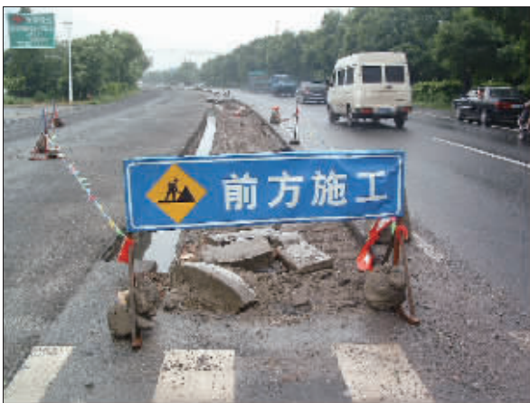
239省道路面大坑小坑不断
