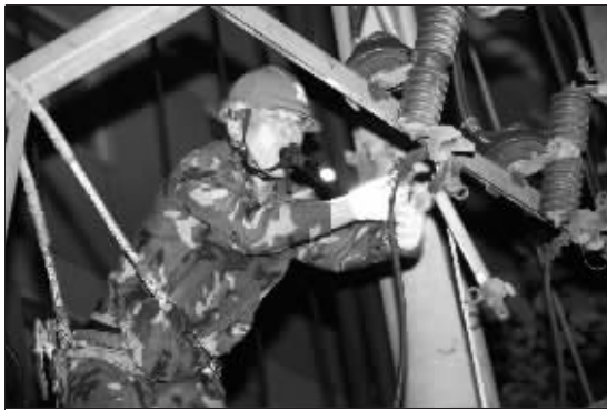
昨日 19:34,因雷击造成 10 千伏百子亭线路设备损坏,南京供电部门紧急启动应急预案,公司领导靠前指挥,紧急组织现场勘察,两小时就完成抢修,得到周围居民的称赞。 巩轩/摄
