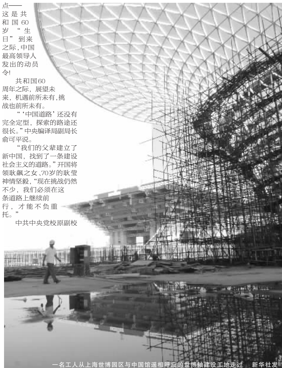
一名工人从上海世博园区与中国馆遥相呼应的世博轴建设工地走过 新华社发
