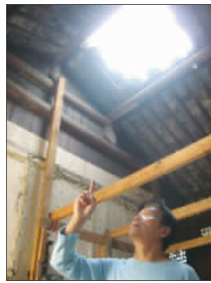
古建筑屋顶被“拆”个洞
