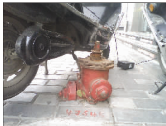
这个消防栓的出水口被堵死了,想让它流点水很难
