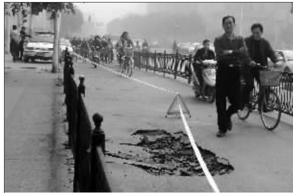
塌陷处已被警戒线围了起来 快报记者 李绍富 摄
