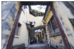
墙上的黄色油漆脱落后,露出了古老的青灰色
