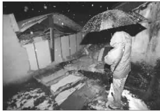
除了屋顶,边上一堵墙也倒了
