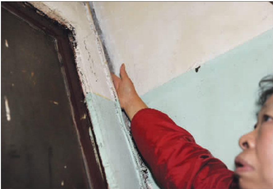
像这样的裂缝,王大妈家有好几道 快报记者 施向辉 摄
