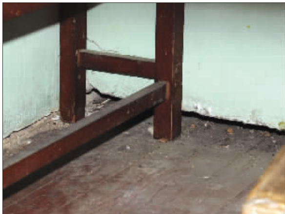
从墙角能清晰地看出楼板下沉严重 快报记者 施向辉 摄
