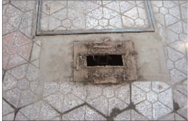
近日,读者张先生经过关河东路小东门桥附近人行道时,看见地上有一块“大嘴巴”,附近还有四只生锈的螺丝,过往行人纷纷避开这个陷阱。张先生建议相关部门及时采取措施,避免行人受伤。 张宇 刘劲松 文/摄
