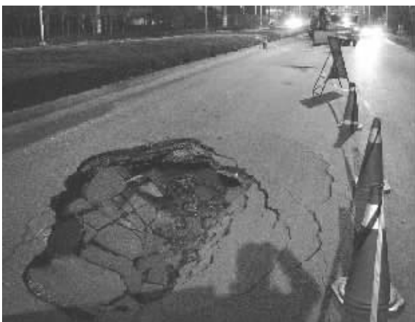
道路上塌出一个长约4米,宽3米的坑洞
