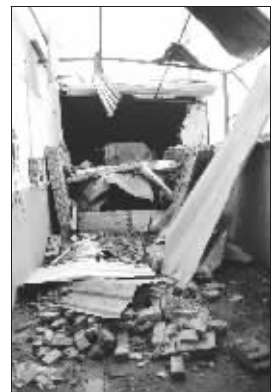
烘干车间墙倒屋塌
