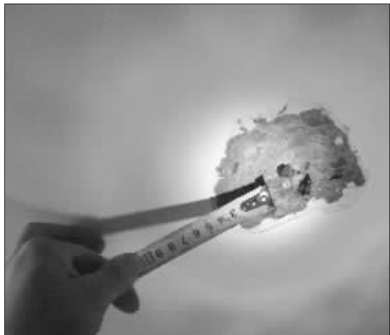
国家规定混凝土里主钢筋口径应在8至10毫米,但昨天现场量出来的只有6毫米 快报记者 赵守诚 摄
