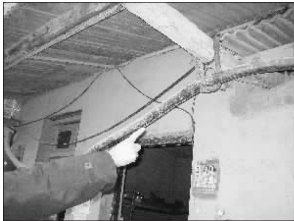
工人指着门卫室房顶处的一根钢筋说:“当时小偷就是吊在这根钢筋上的。”
