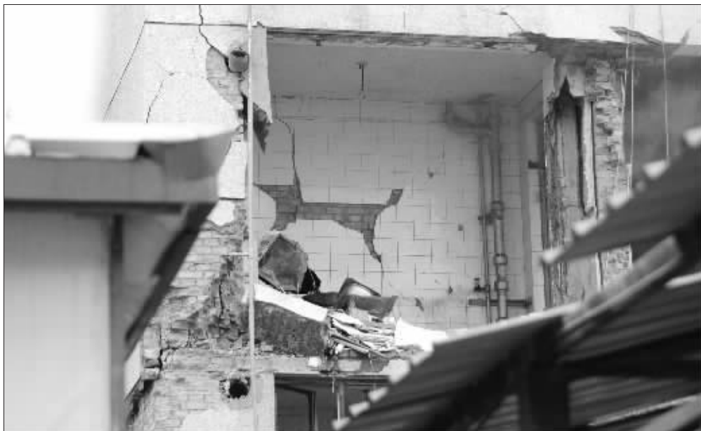
楼板都被炸塌
