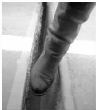
脚能塞进裂缝
