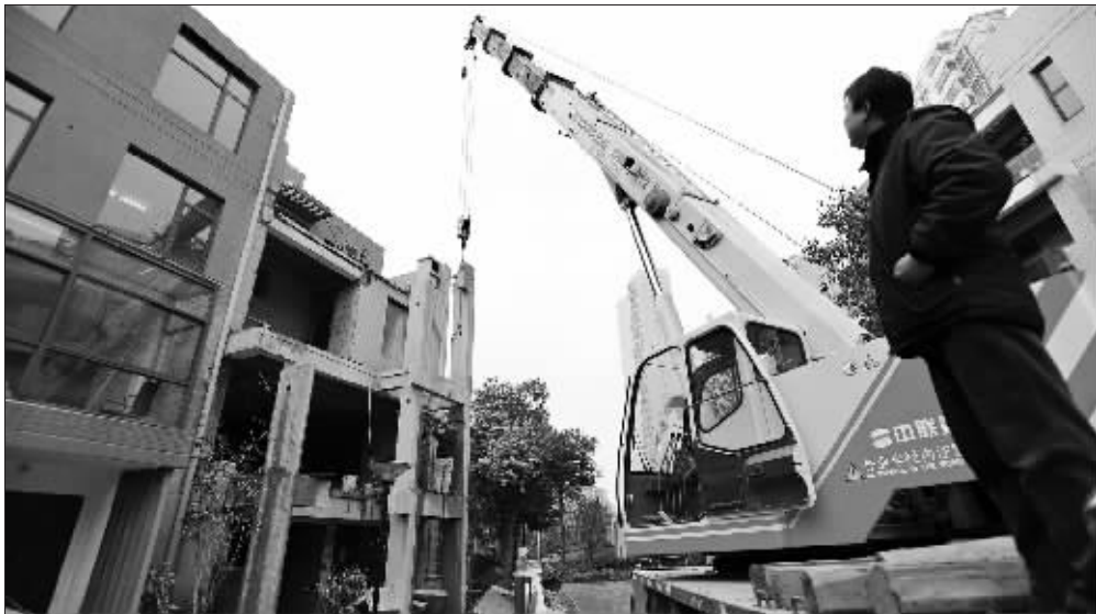
▲4日，工人们正在将紫鑫中华广场内的别墅违建拆除。快报记者 施向辉 摄
