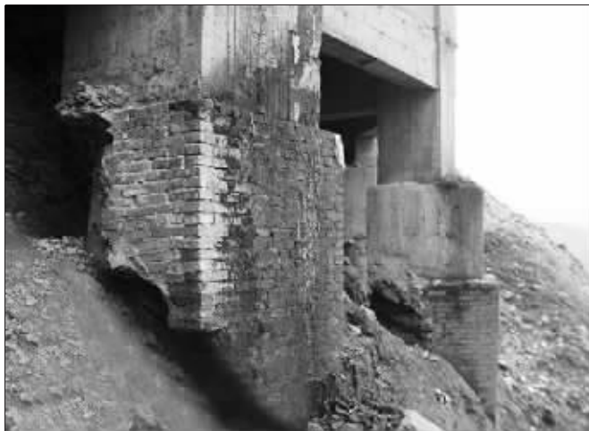
金易花园4栋的楼桩也塌了不少
