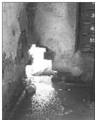
沿河围墙被人挖出了“垃圾洞”
