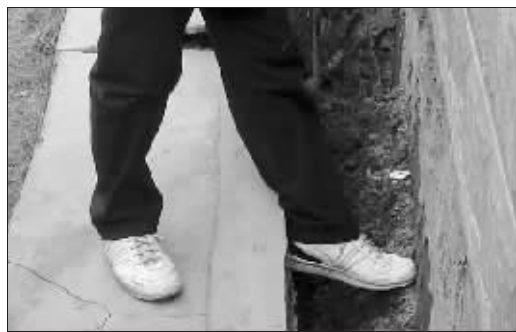
墙脚处的裂口有20多厘米宽
