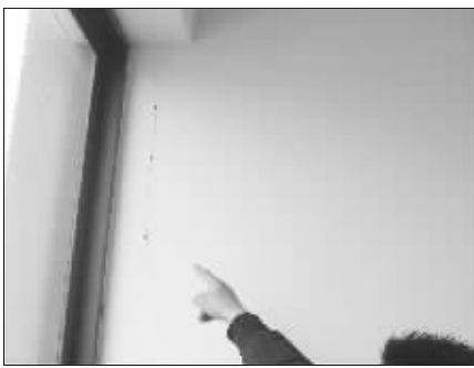
居民家中墙面出现裂纹
