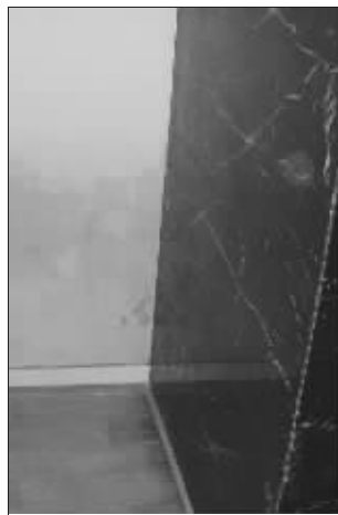
墙面起泡、大理石掉砂掉色
