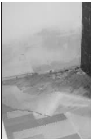
地板霉烂,三分之一被拆掉重铺
