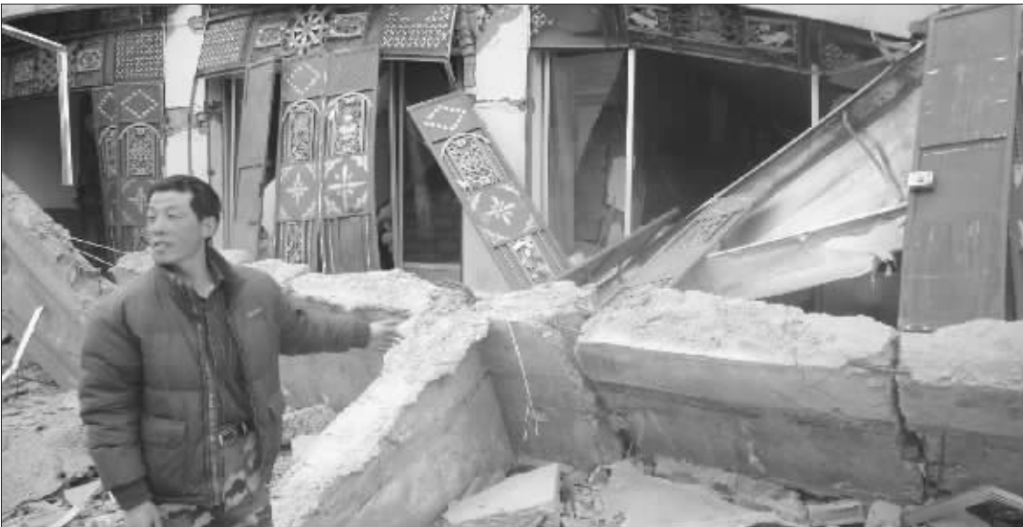
杜平被震塌的房子
