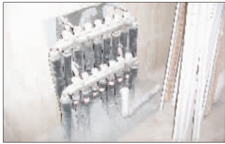
粗糙的施工害苦了业主
