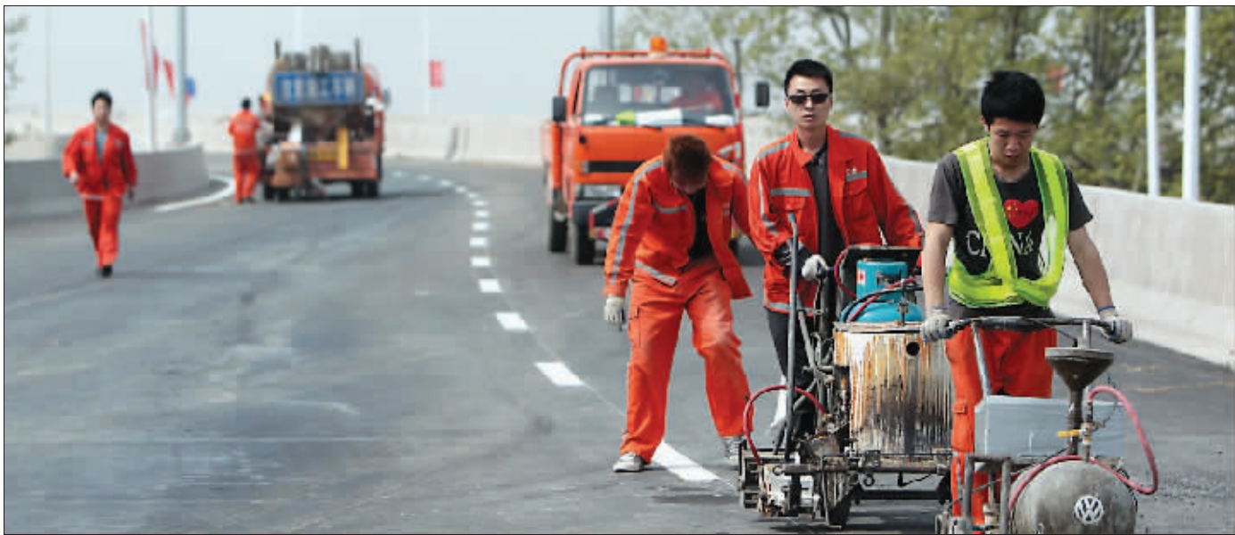
由扬子江大道进入夹江大桥的匝道已经进入路面画线阶段 快报记者 顾炜 摄
