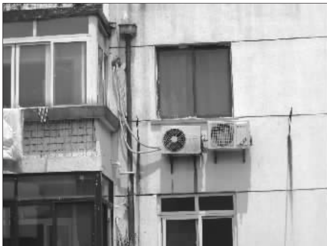
铁皮落水管用了近30年,已经通体生锈 何寅平 摄
