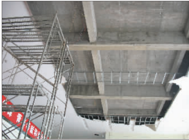
吊顶坍塌后,现场已被清理过 快报记者 刘国庆 摄
