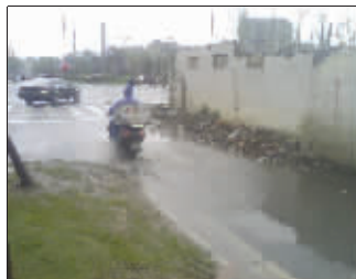
拆了一半的楼占了人行道
