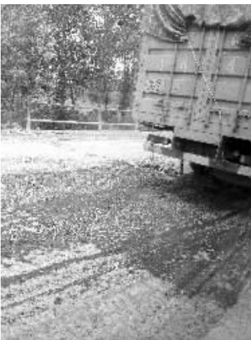
被改装车碾压得支离破碎的路面
