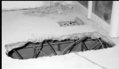
银行楼上商户的地板被凿穿
