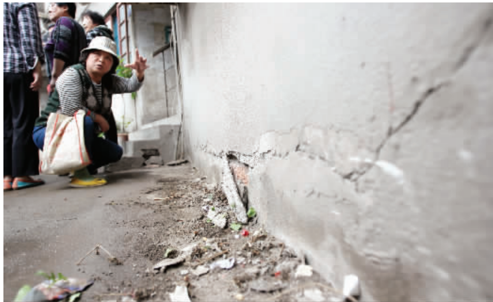
居民楼发生倾斜,外墙出现多处裂缝 现代快报记者 李雨泽 摄
