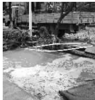
被大水冲开的路面
