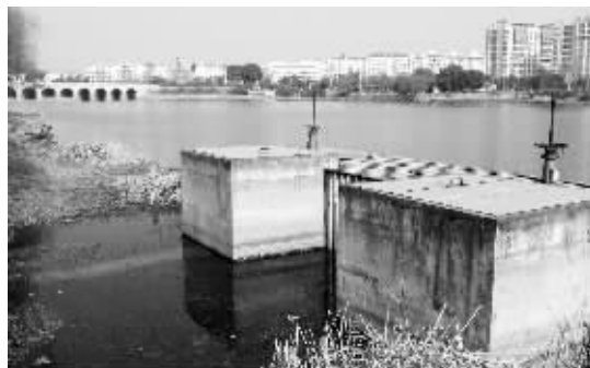
花神湖旁的南京科技馆空调冷却循环水取水口
