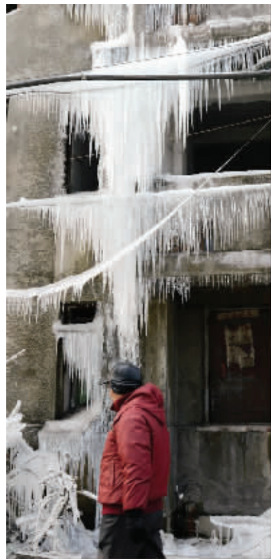
一栋待拆的楼漏水,形成了独特的冰凌景观。
