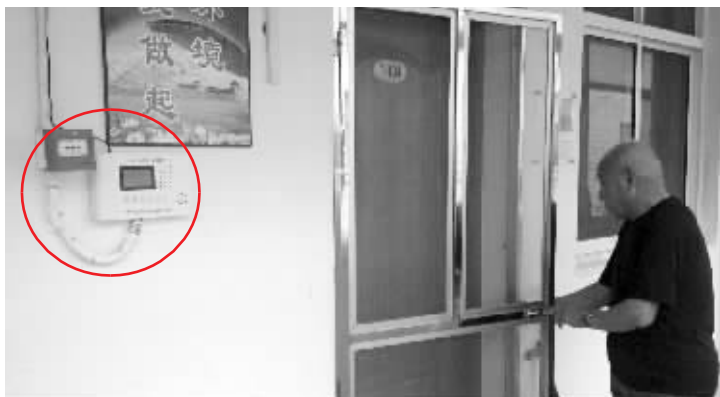
邹区敬老院里安装的火灾自动报警系统(画圈处) 葛小林 摄
