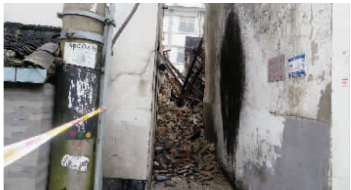
砖瓦房梁散落一地,现场有警戒线禁止通行 蒋雅芳 摄
