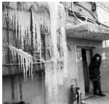
2月26日,沈阳一小区楼顶的太阳能热水器漏水,从5楼至3楼的阳台已悬挂厚厚的冰溜,看起来十分危险,楼下结冰也很严重。 CFP供图
