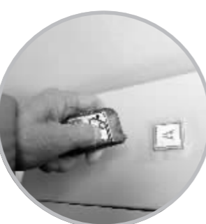
“楼道电梯”的控制设备
