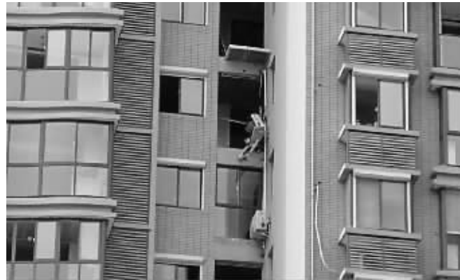
炸坏的空调还挂在外墙上 网友供图
