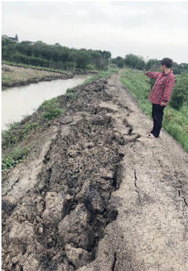
圩堤多处开裂坍塌,村民十分忧心
