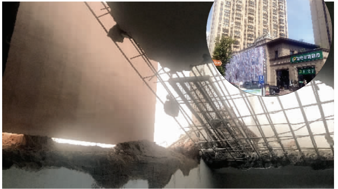
大图:消防通道通往一楼的楼面和楼梯被破坏 小图:商铺已经停工 现代快报+/ZAKER南京记者 蔡梦莹 摄
