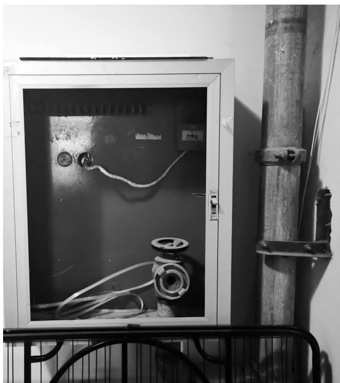
小区37幢消防栓缺失
