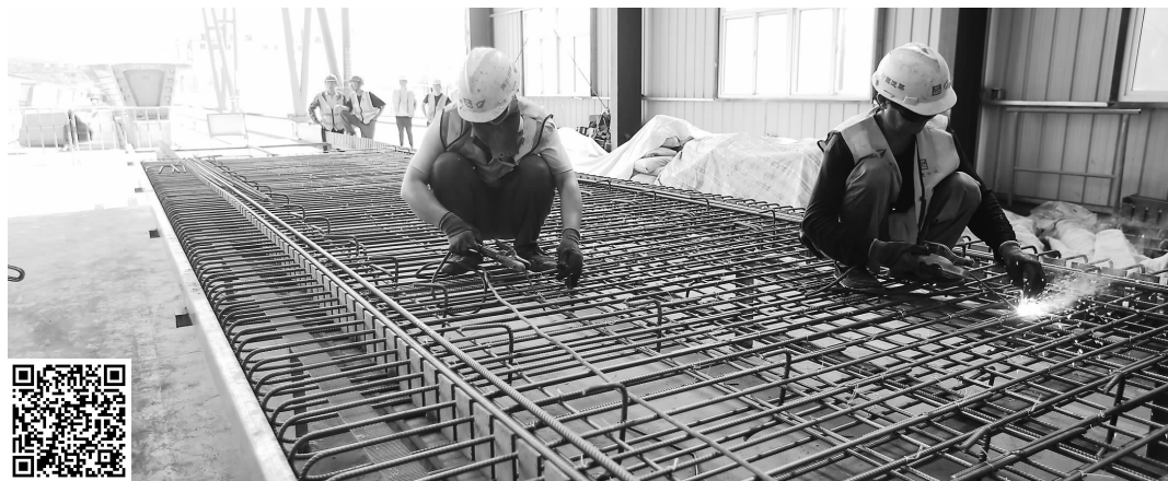
钢筋捆扎工在厂房里施工作业 現代快報+ZAKER南京記者 顧煒攝
